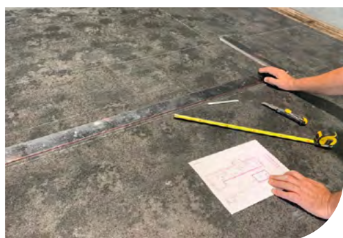
Contrôle de l'appareillage
