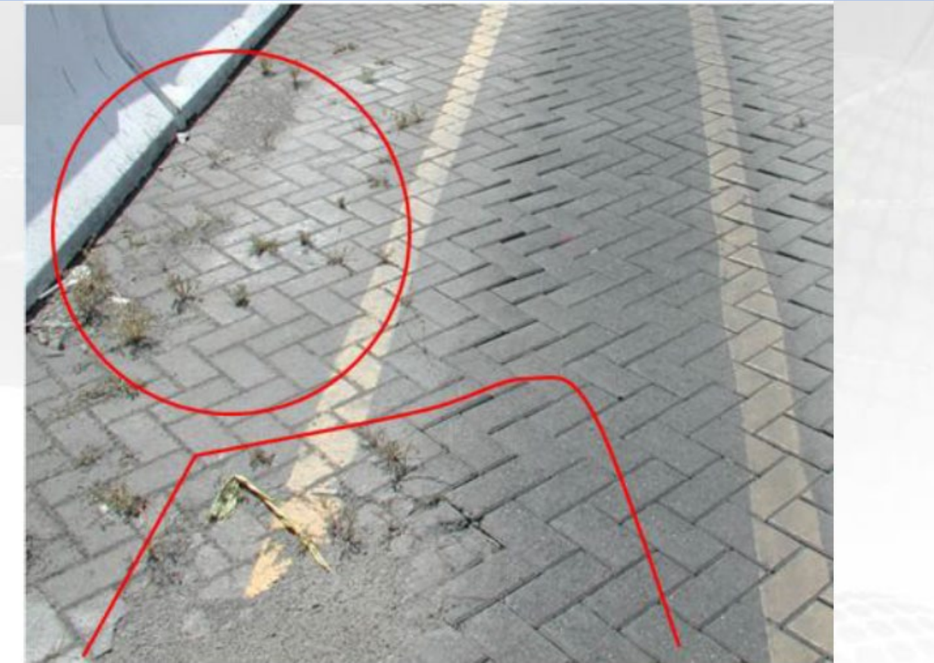
Boues blanches d'attrition à côté des traces de roues jumelées des RTG (source photo : groupe de travail PIANC chaussées portuaires – avril 2014)
