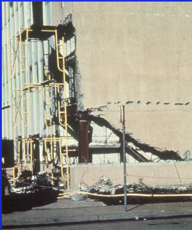
Mur non chaîné, séisme d'Anchorage, Etats-Unis 1964
