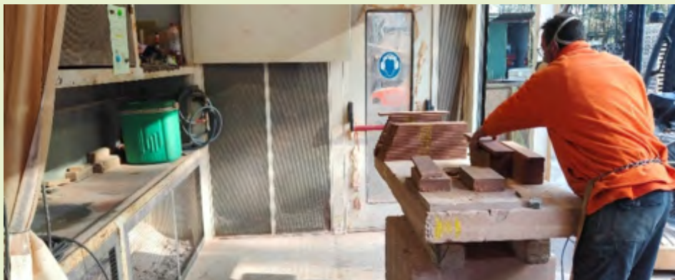
Exposition d'un opérateur à de la poussière pendant une opération de découpe. Photo : CTMNC
